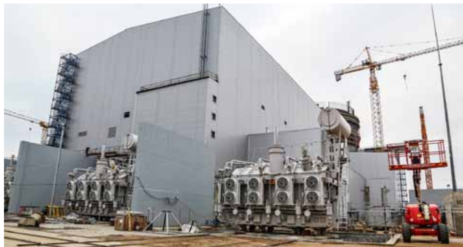
Transformátory před strojovnou 1. bloku Leningradské JE-2
